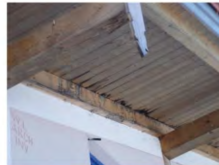
Figura 2.42 - Danni in conseguenza della mancata tenuta all'aria nel collegamento del tetto con la parete in muratura (Fonte: NaturaliaBau)
