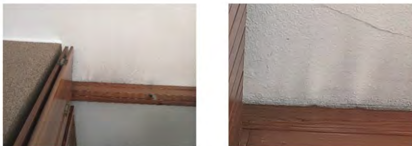
Figura 2.60 - Esempio di esfiltrazione tra solaio e infissi
